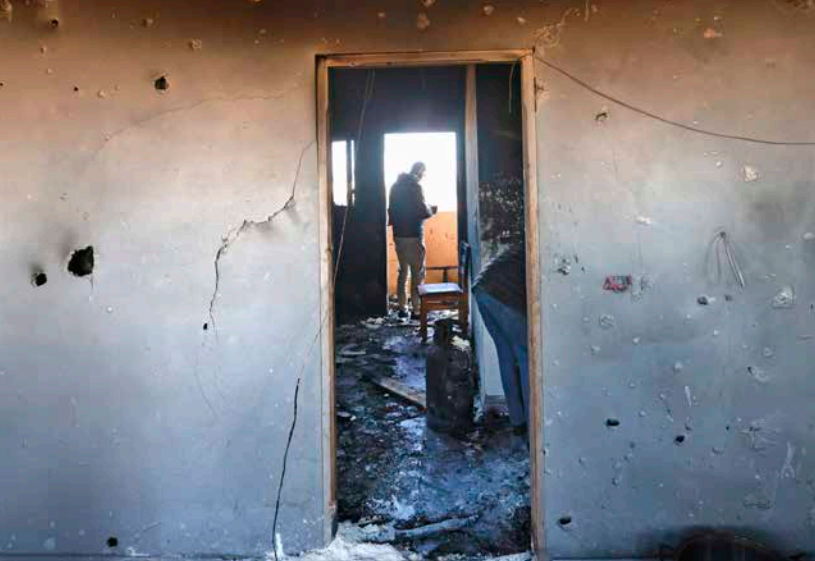
Attack mot ett hus i Khan Yunis där Läkare Utan Gränser personal och deras familjer sökt skydd. Minst två personer dödades. BILD MSF, 21 FEB 2024
